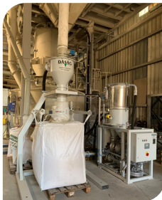
Rückmehlsystem einer Packanlage mit Fehlsackaufgabe und BIG BAG-Füllstation
