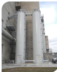
Silo-Anlage für Eisen(II)-Sulfat
